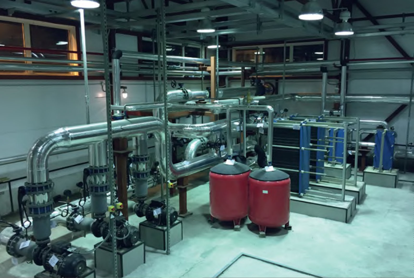
Котельная, г. Апатиты
